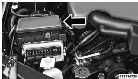
Коммутационный блок (ТПМ)
