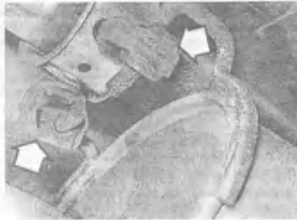
Проверьте состояние системы выпуска отработавших газов, особое внимание уделяя ее подвесам (стрелки)
