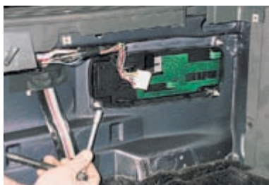
Для снятия фонаря головкой «на 8» отворачиваем четыре гайки (под одной из гаек расположена клемма «массового» провода).
