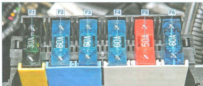
Блок предохранителей в моторном отсеке
