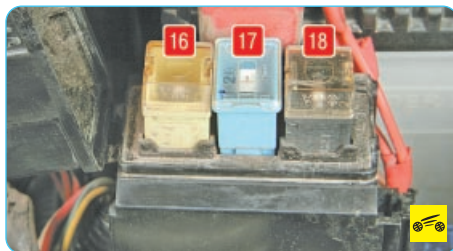
Рис. 10.3. Предохранители на клемме «плюс» аккумуляторной батареи
